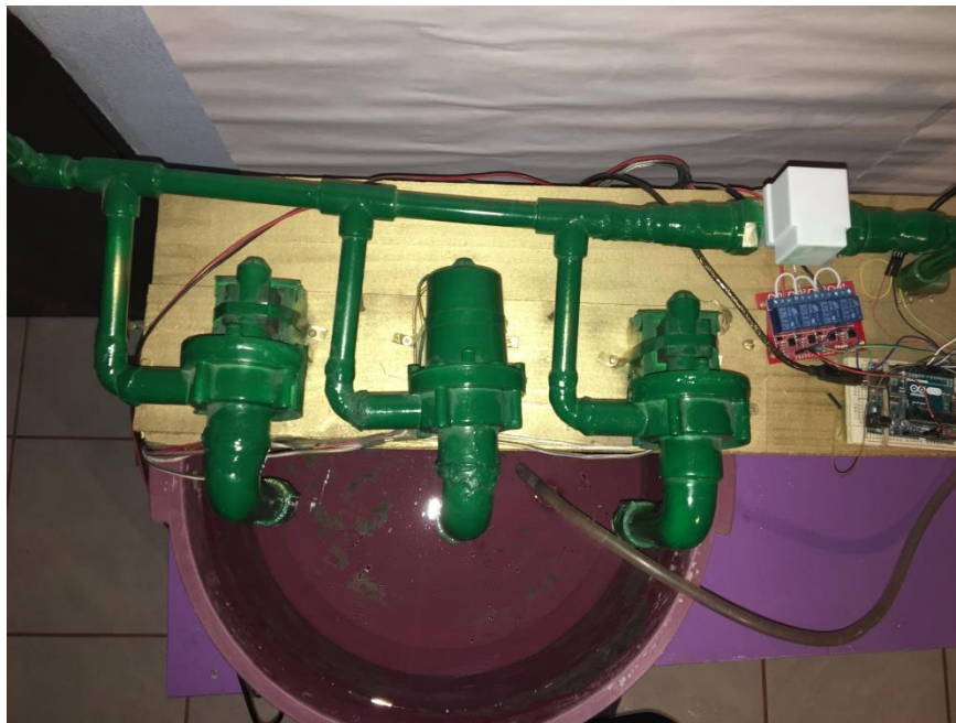
Imagen 4-14. Vista superior de la conexión de las bombas de agua.
