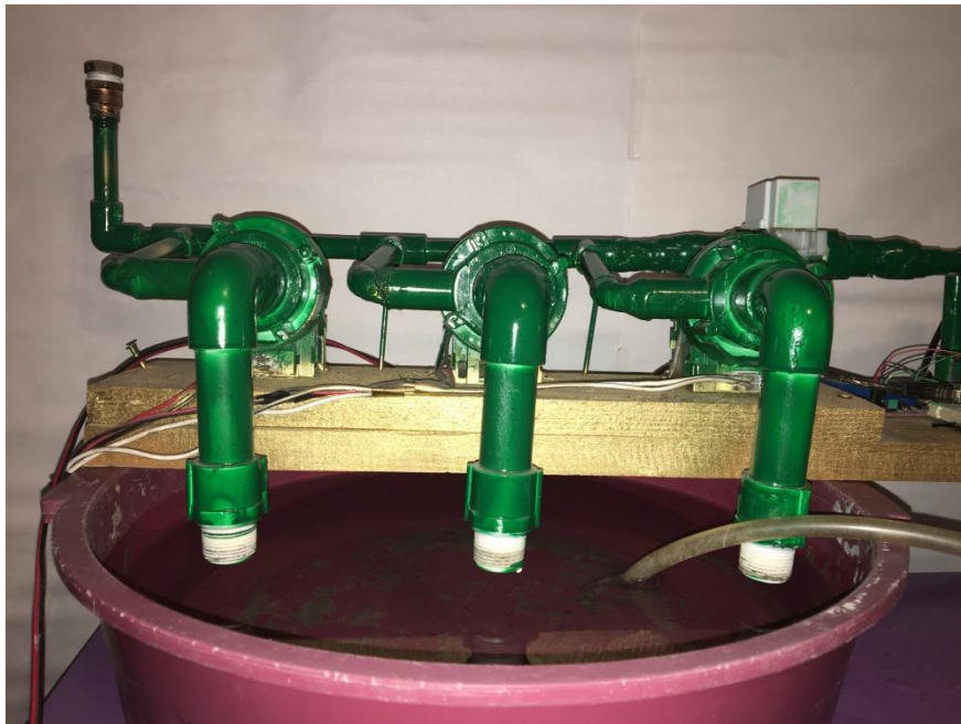
Imagen 4-13. Vista frontal de la conexión de las bombas de agua.
