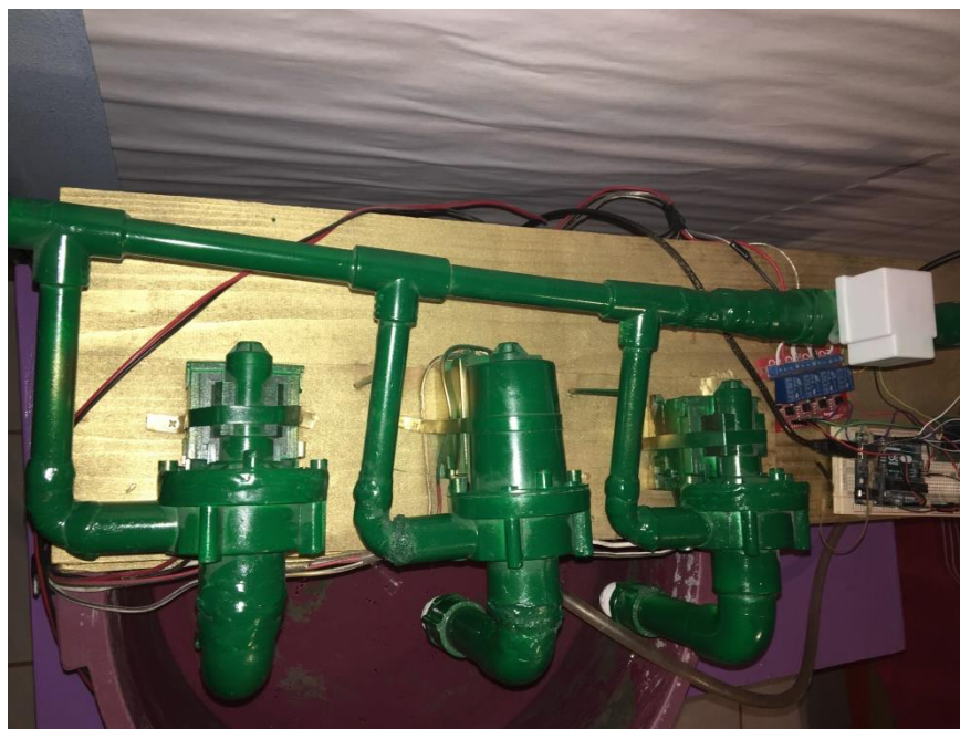
Imagen 4-15. Conexión de bombas de agua.
